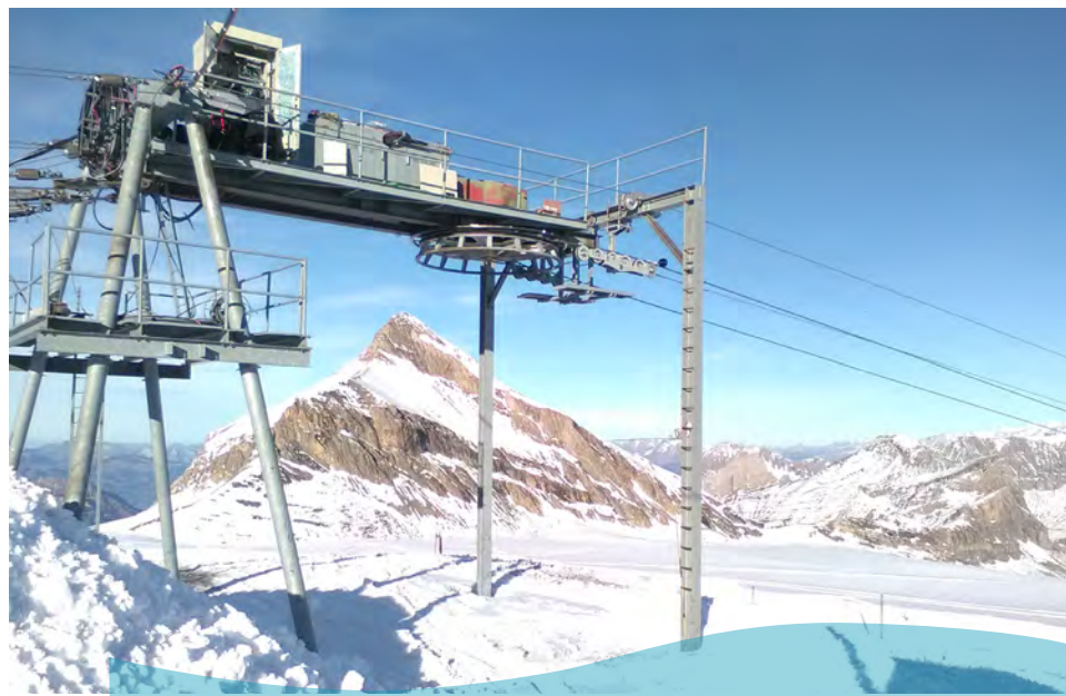
Le U1000 de Yaskawa : un contrôle efficace des remontées mécaniques assure un fonctionnement durable grâce à la récupération de l'énergie de freinage.
