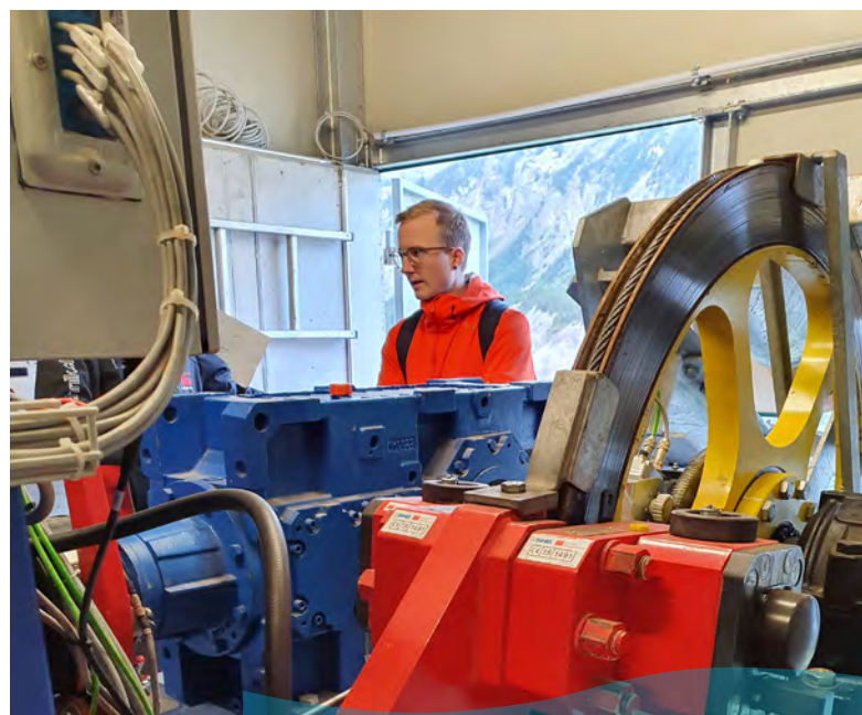
Mise en service d'un U1000 dans un ascenseur incliné
