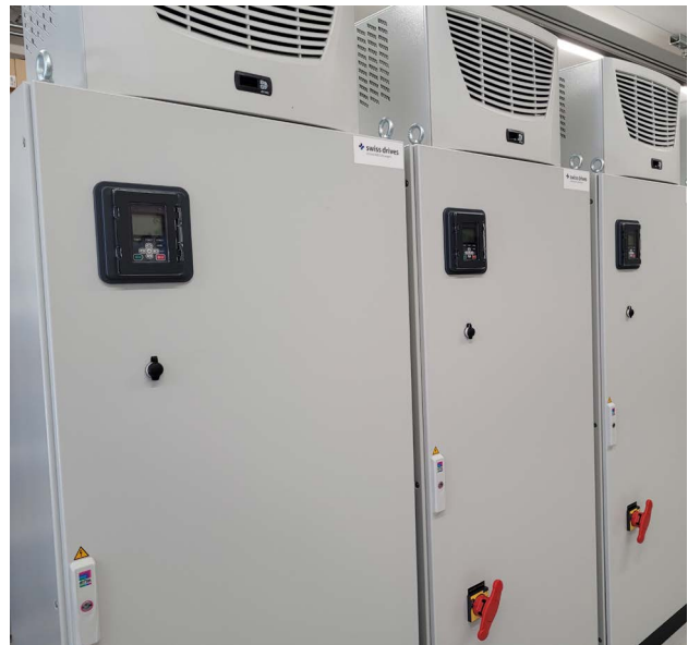
Auf Kundenwunsch verbauen wir die Umrichter in IP54-Schaltschränken, die die Geräte zuverlässig schützen und für einen sicheren Betrieb sorgen.
